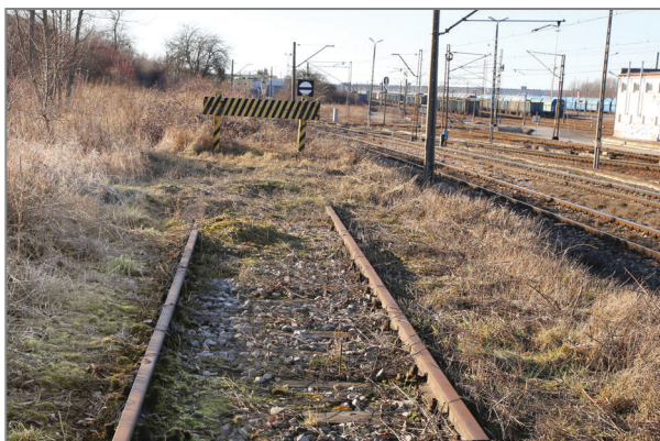
12. Kozioł oporowy bocznic kolejowej, która prowadziła do powojennego zakładu Ślichowice, 2022 r., fot. P. Król.
